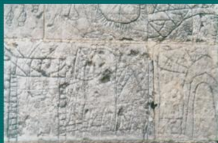
Graffiti sur les murs de l'église
